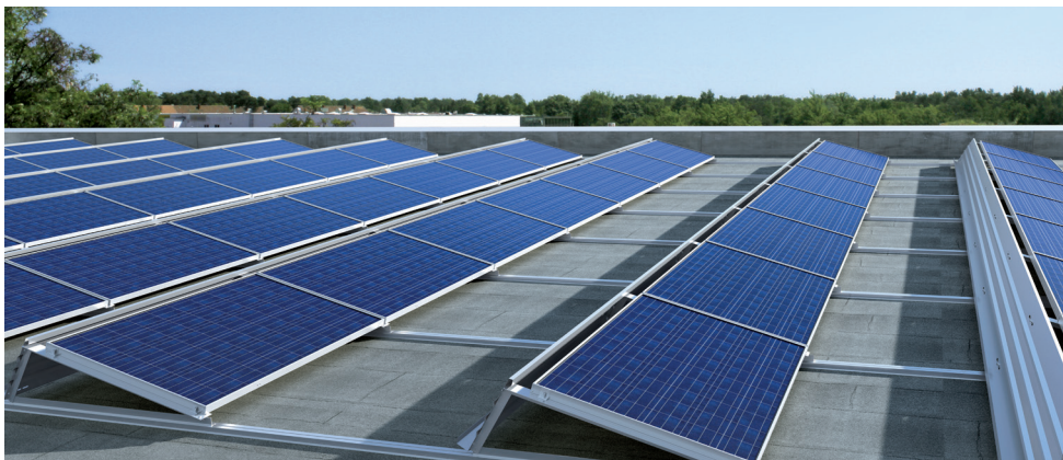
Solcellssystem monterat på ett plant tak
